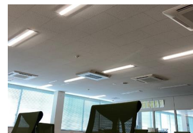
事務所照明のLED化
